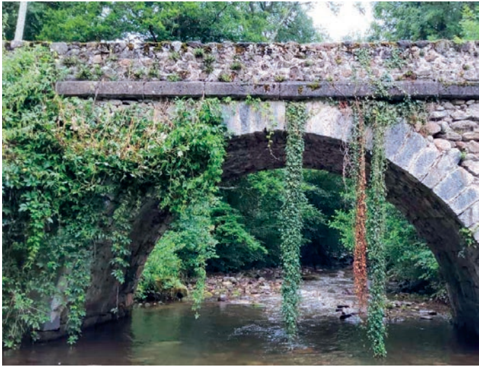
La végétation envahit le pont voute Pomiès
